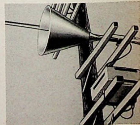
Bild 2. Trichter und Zwischenverstärker auf der 24-km-Strecke
